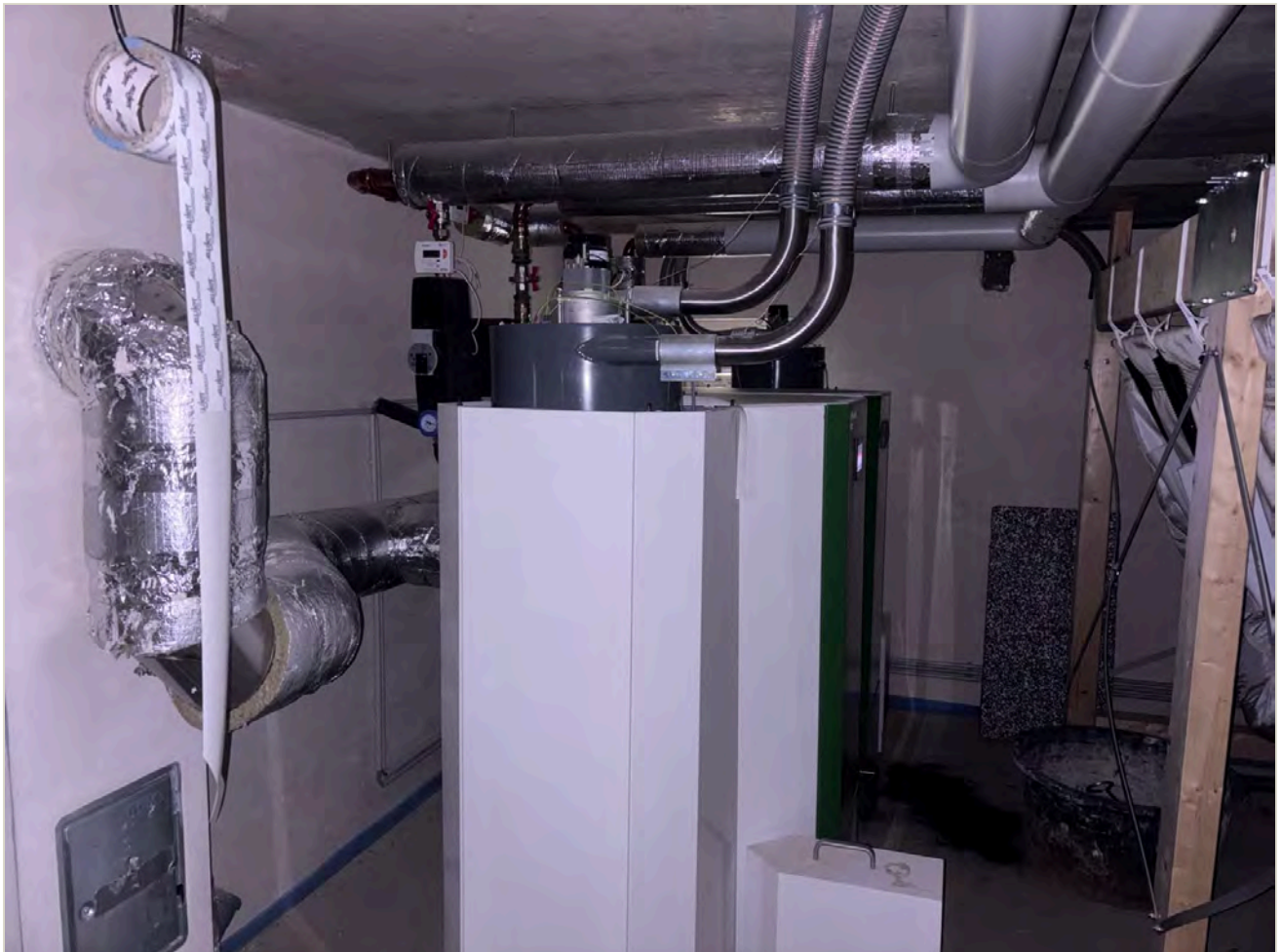
Moderne Pelletheizungsanlage im Keller
