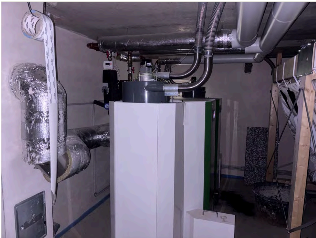
Moderne Pelletheizungsanlage im Keller
